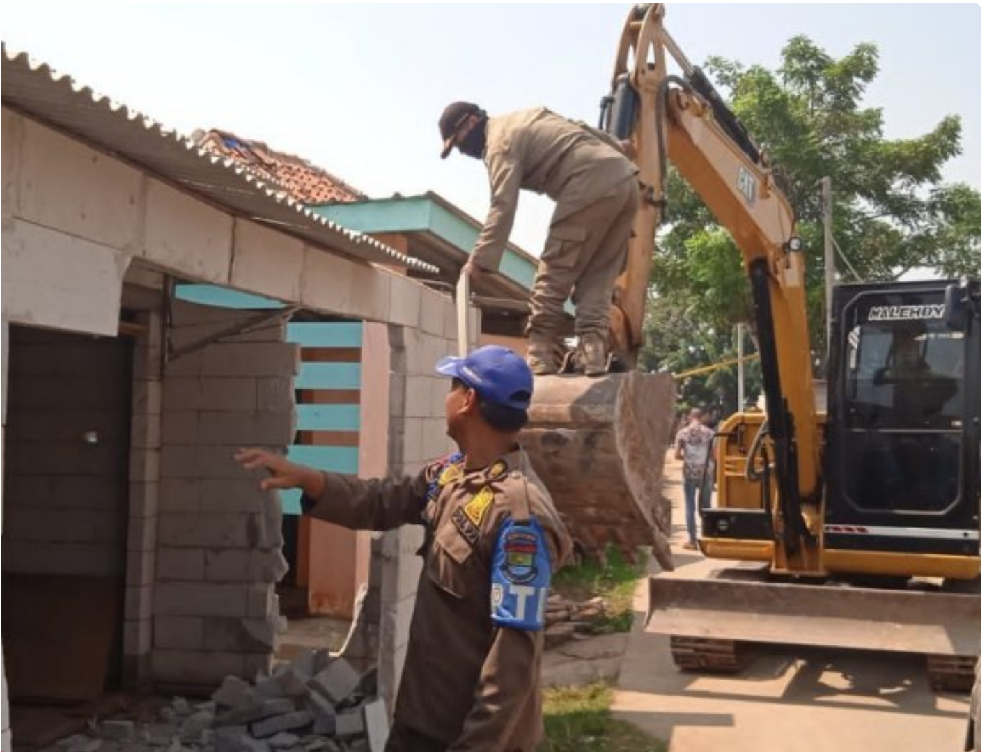
Satpol PP Kabupaten Tangerang saat melaksanakan Pembongkaran Bangunan disepanjang Bantaran Kali Alar Jiban
